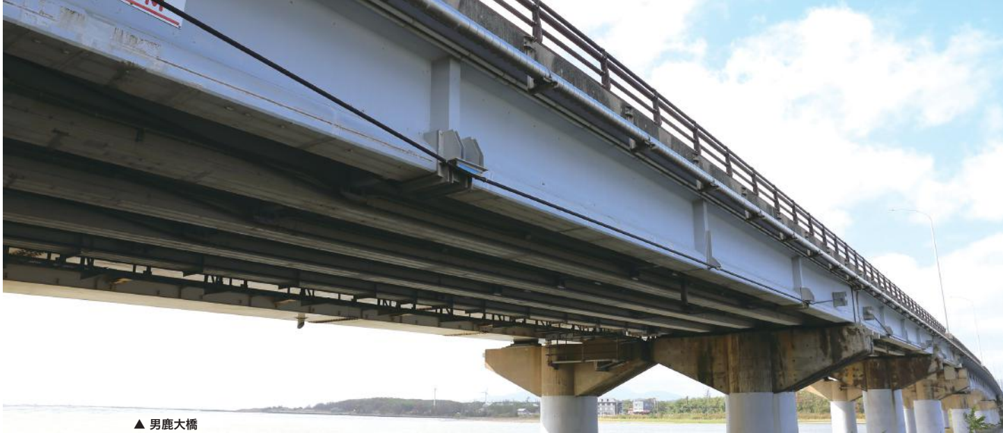
▲ 男鹿大橋 平成14(2002)年に拡幅工事と同時に、活荷重の増大への対策として外ケーブルの補強工法を、塩害対策として電気防食工法を実施。
