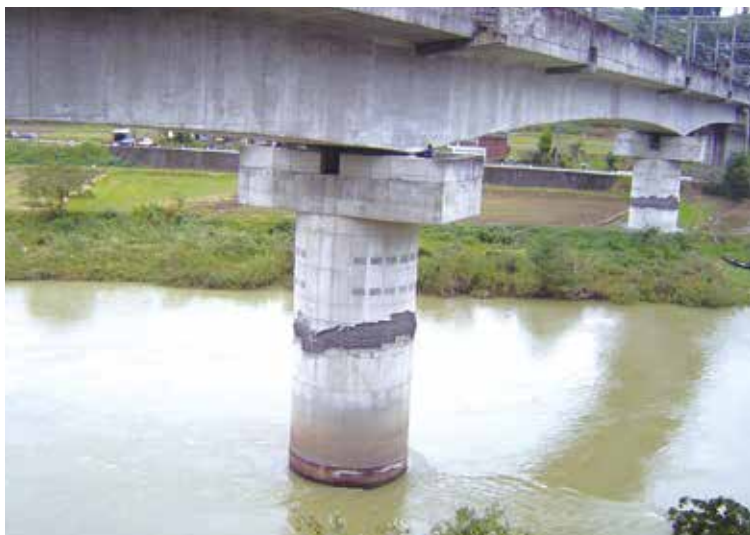
▶新潟県中越地震において被災した上越新幹線魚野川橋梁(分ぶりコンクリートが一部剥落したが橋脚の軸力保持機能は保たれ、軌道は元の位置を保っていた)。(提供：下村匠氏)
