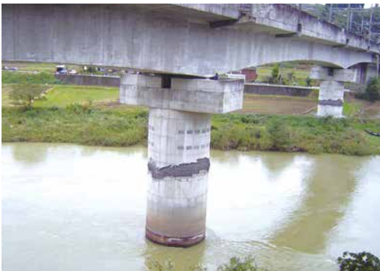
▶新潟県中越地震において被災した上越新幹線魚野川橋梁(かぶりコンクリートが一部剥落したが橋脚の軸力保持機能は保たれ、軌道は元の位置を保っていた)。(提供：下村匠氏)
