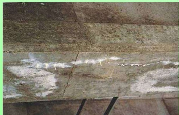
写真5. 4. 2 PC鋼材に沿う ひび割れ (主桁底面)
