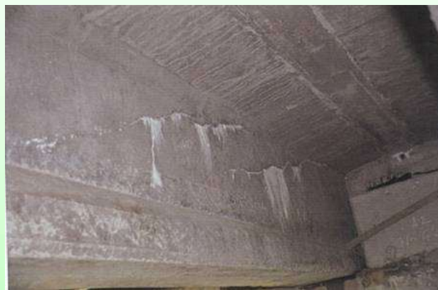
写真5. 4. 1 PC鋼材に沿う ひび割れ (主桁側面)
