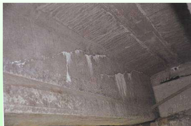
写真5.4.1 PC鋼材に沿う ひび割れ（主桁側面）
