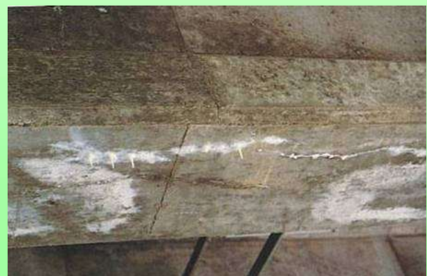
写真5.4.2 PC鋼材に沿う ひび割れ（主桁底面）
