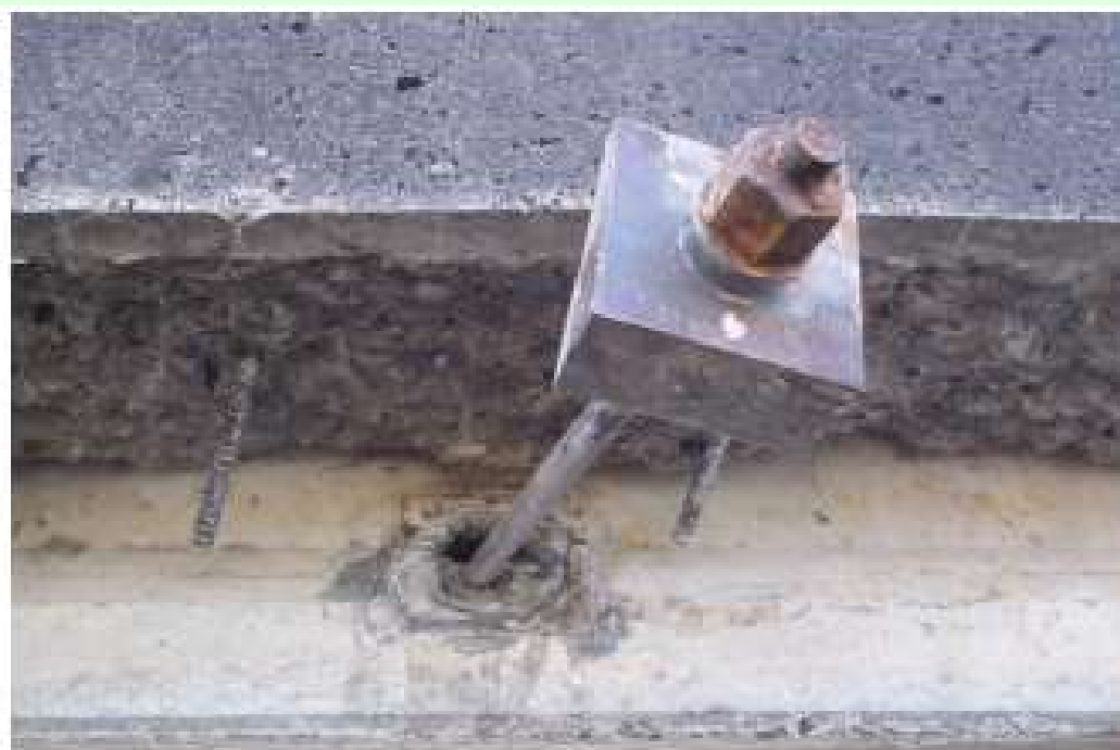
写真 2. 1. 2 PC 鋼棒の突出
