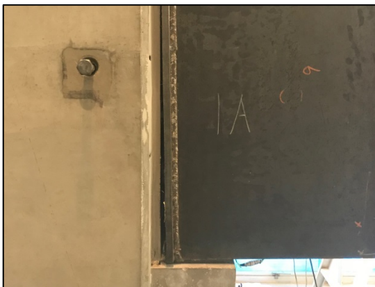
写真6 r_s=1/15 時の目地の離間状況
