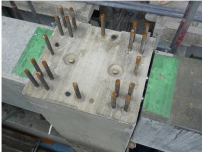
写真-4 柱頭主筋状況
