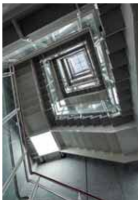
階段室：シースルー太陽電池一体型トップライト
