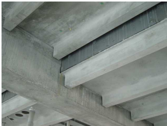
写真 - 5 スパン方向スラブ段差 (PCaPC)
