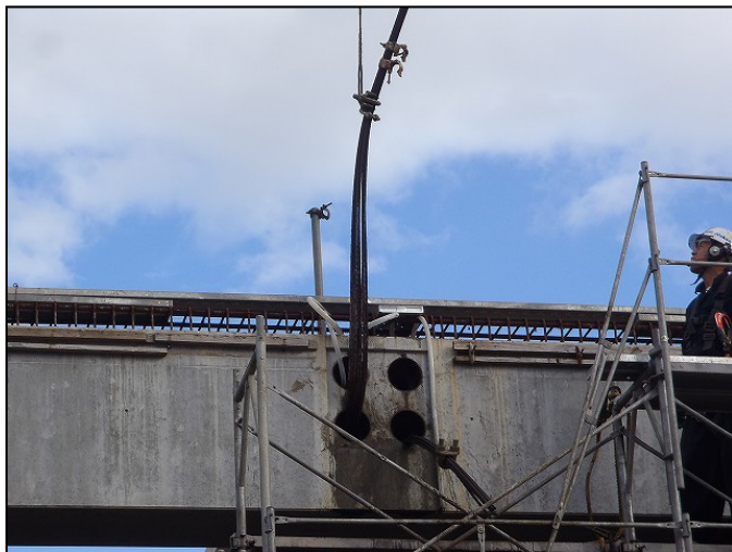
PC鋼線引抜状況
