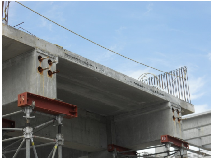
臨港道路：P C鋼線の錆
