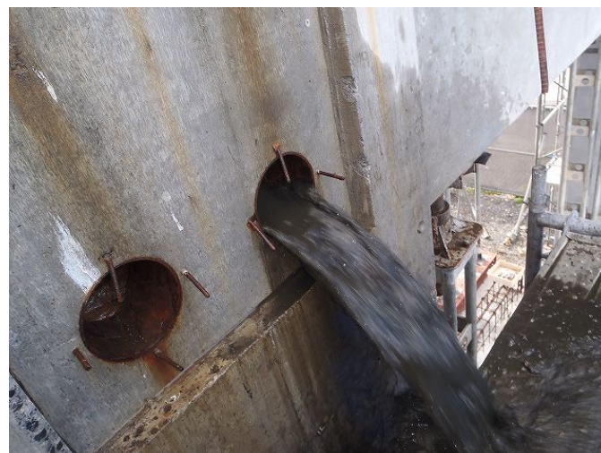
シース管内の海水排出状況
