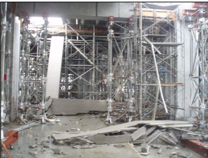
人工地盤棟：P C床の落下・支保工の移動
