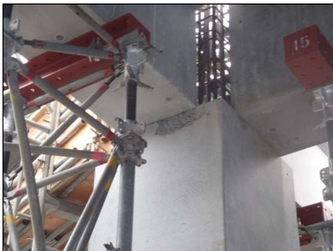
PC柱の欠損部状況
