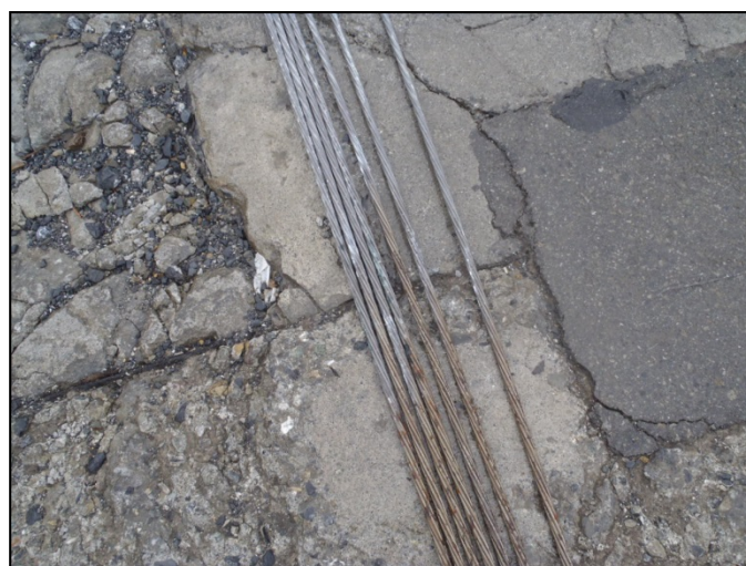
撤去後のPC鋼線の状況
