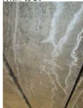
写真-2 凍結融解によるスケーリングと桁下面ひび割れ
