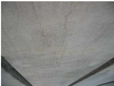
写真-1 ASRによる桁下面ひび割れ
