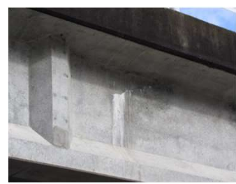
写真-3 PC鋼材に沿ったひびわれとエフロレッセンス
