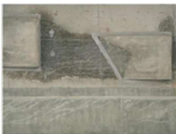
写真-1 連続合成桁一次床版の水しみ
