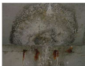
写真-2 横桁のコンクリート打設孔からの漏水
