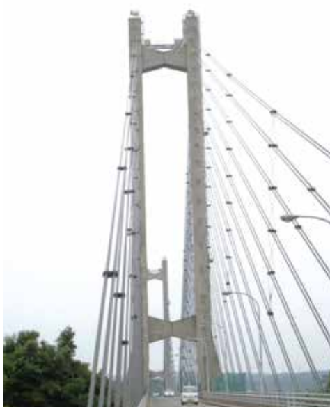
▲ 写真-4 斜材制振装置
