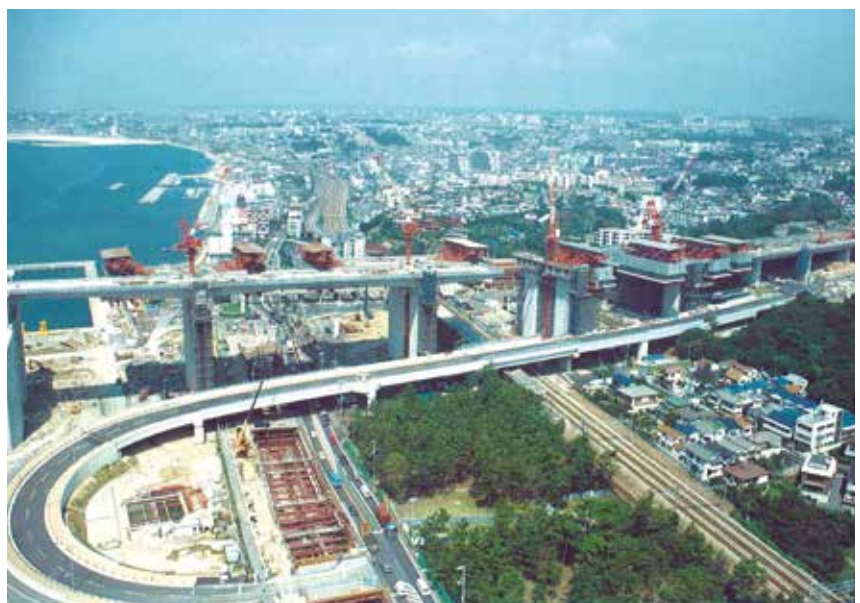
▲ 舞子高架橋 国道・鉄道が交差する条件での上部工施工
