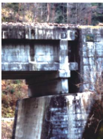
▲コンクリートロッカーシュー(可動)
