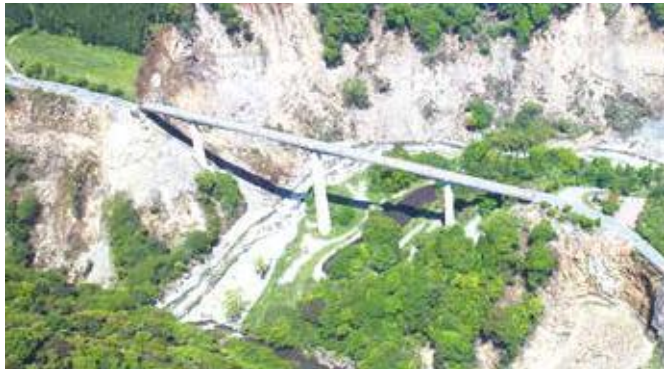
▲ 写真-2 落橋を免れた阿蘇長陽大橋
