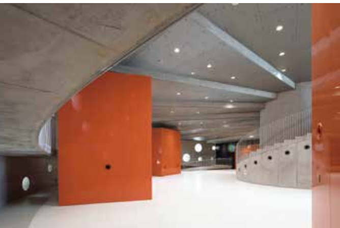
▲ 回廊屋根部に螺旋階段状に配置された場所打ち PC 梁
