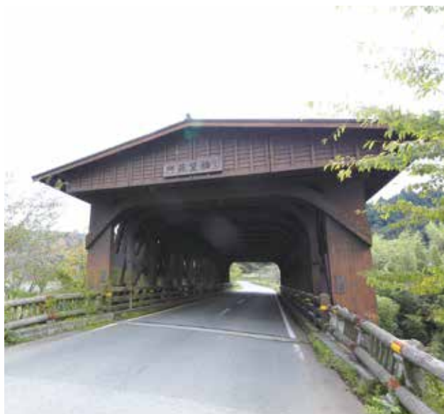
▲阿蘇望橋 屋根付き木造ラチストラ橋。橋長41.6m、幅員7.0m。構造部材は主に地元産のスギを使用。特に強度を要する下弦材等には鋼材、上弦材・斜材・床板には集成材を使用したハイブリッド橋。屋根は木材の劣化を防ぎ、耐久性を高めるために取り付けられた。
