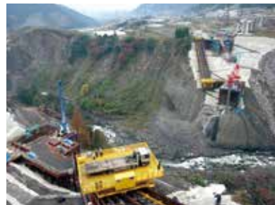
▲ インクライン設備 移動台車(黄色)、奥の対岸斜面にはレールも見える。
