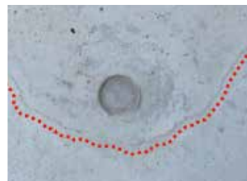
沈みひび割れ
