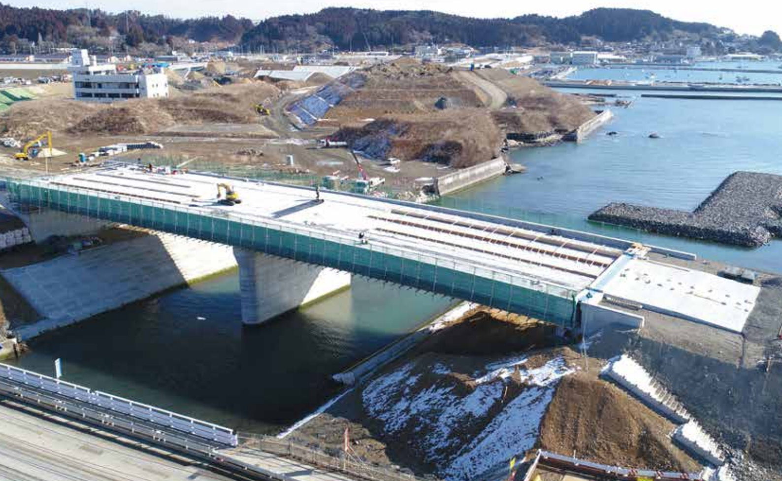
▲写真-1 震災後、高耐久仕様により架替えられた水尻橋(PC 2径間連結ボスチン中空床版橋)
