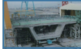
プレキャストセグメント(PC箱桁) あらかじめ工場や製作ヤードで分割して製作したプレキャスト部材を架設地点で接合しプレストレスを与えて一体化する工法。⇒作業性、品質向上。
