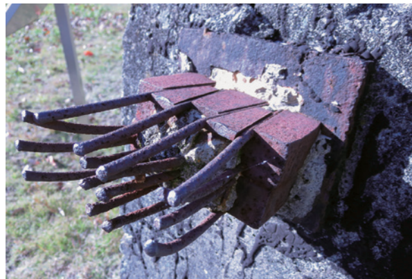
写真-4 マグネル定着具(東京駅ホーム桁)
